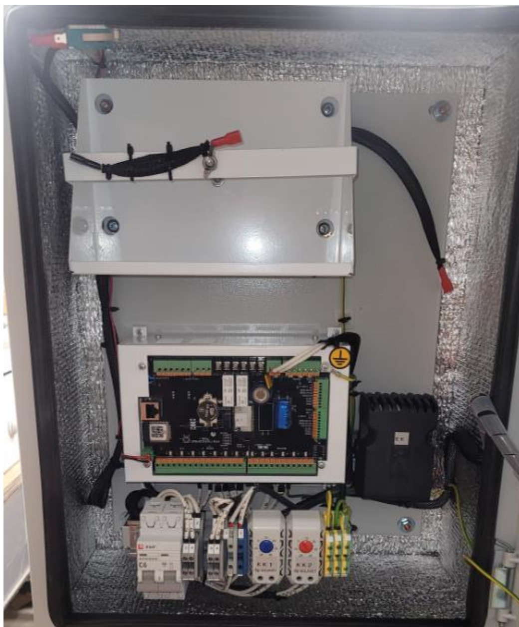
Рисунок 1.4 - Общий вид шкафа
